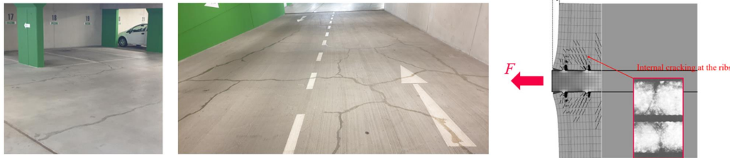
Abbildung 2.6.5: Abbildung 16 – Unerwartete Rissöffnung im Nutzungszeitraum durch Verbundschädigungen infolge zu früher Makrorissbildung während der Betonerhärtung
